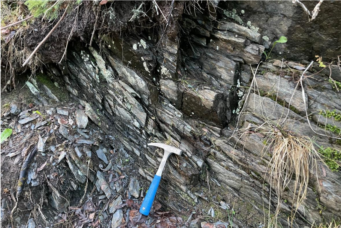
Foto 3-3: Silsteinslag med foliert og flisig struktur som er tydelig påvirket av overflateforvitring. Bildet er tatt ved kartleggingslokalitet 57 ved ca. profil 11 200. (Kilde: Norconsult).
